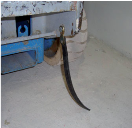
Bild 4-9: Antistatikband zur Ableitung elektrostatischer Aufladungen der Hubarbeitsbühne
